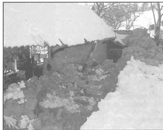
A zsidótemető déli kerítésfalának egy része rádőlt a vele szomszédos ház melléképületére Fotó: Kovács Zsolt
